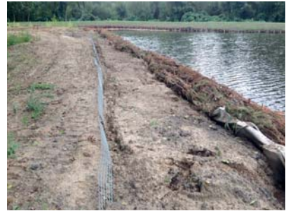
Abb. 47: Edelstahlschutzmatten als Uferschutz an Kanalseitendämmen
