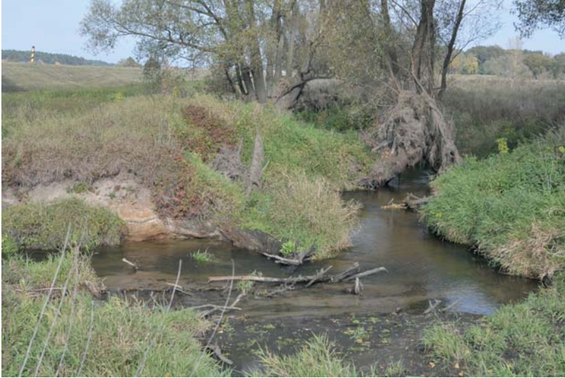
Abb. 4: Eigendynamisches Prallufer mit Ufererosion am Grano-Buderoser Mühlenfließ, ca. 100 m oberhalb der Mündung in die Lausitzer Neiße
